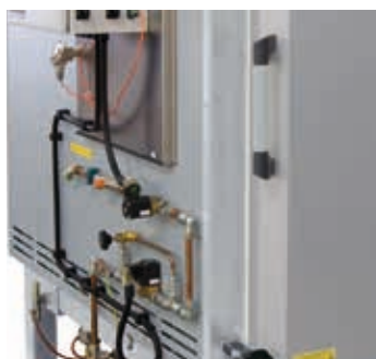
Gasleiding en thermo-element aan de oven
